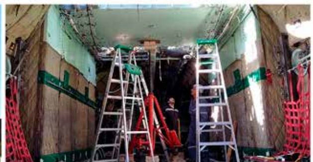
Interior C-130 Centro Plano desmontado interno.
